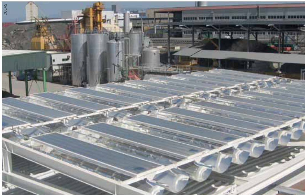
Installation de démonstration construite sur le toit de l'entreprise COLAS de Genève, avec ses 20 capteurs et les citernes de bitume qu'ils chauffent à l'arrière-plan.
